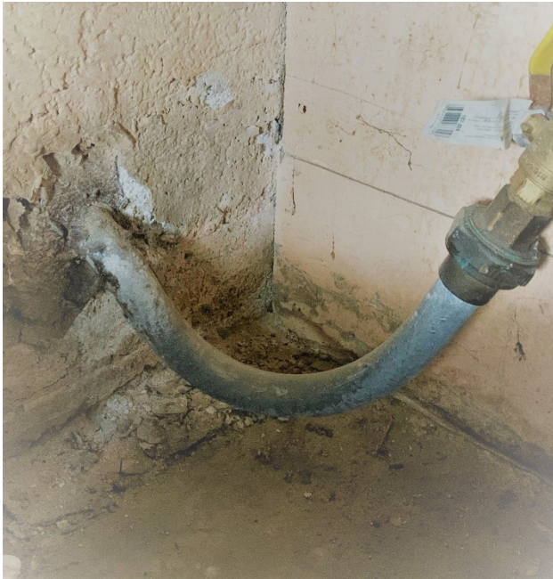
Foto de una línea de servicio de plomo en una casa en North Platte, NE.
